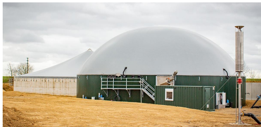
Unité de méthanisation de la ferme des Peupliers à Flipou. Source : Ferme des Peupliers
